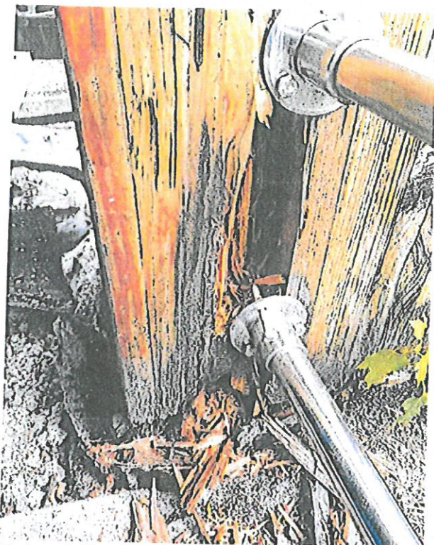
Fot nr 9 Zniszczenie drewna przy podporze.
