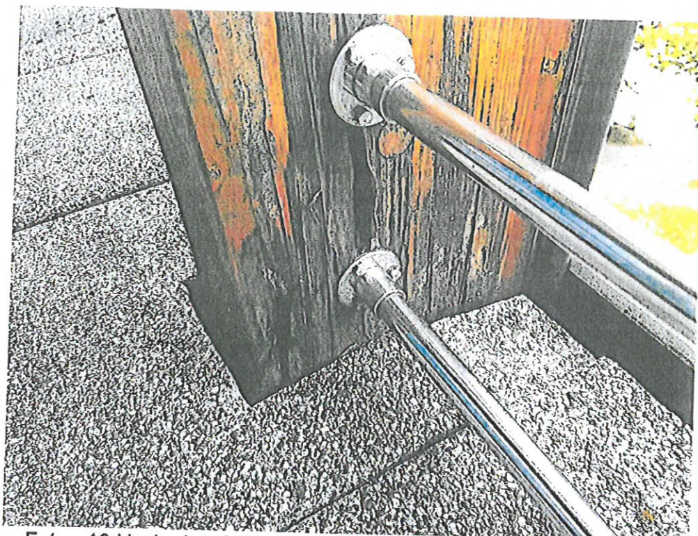
Fot nr 13 Uszkodzenie drewna klejonego w strefie przypodporowej.
