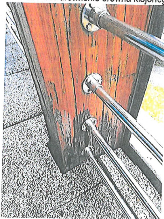
Fot nr 12 Uszkodzenie drewna klejonego w strefie przypodporowej.
