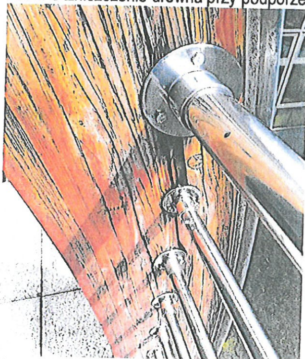
Fot nr 10 Rozwarstwienie drewna klejonego.
