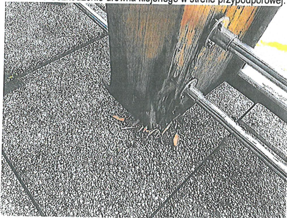
Fot nr 16 Uszkodzenie drewna klejonego w strefie przypodporowej.
