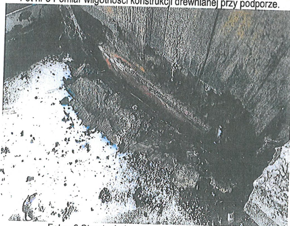
Fot nr 6 Stan techniczny drewna przy podporze.
